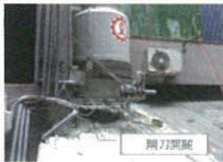
冷卻水塔，左側開刀開關，及下方鐵架均帶電。
